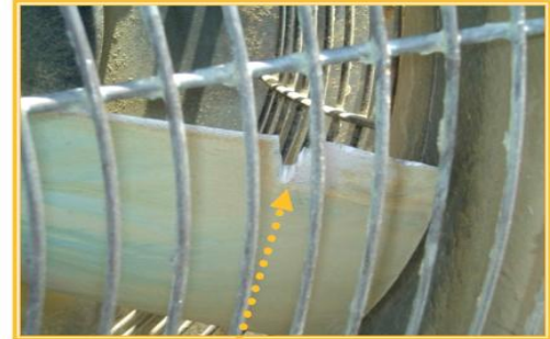
Fig. 19. Ventilador con álabes en mal estado.
